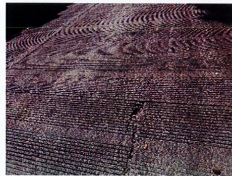
K0+500-K0+597 现状水泥路面病害
