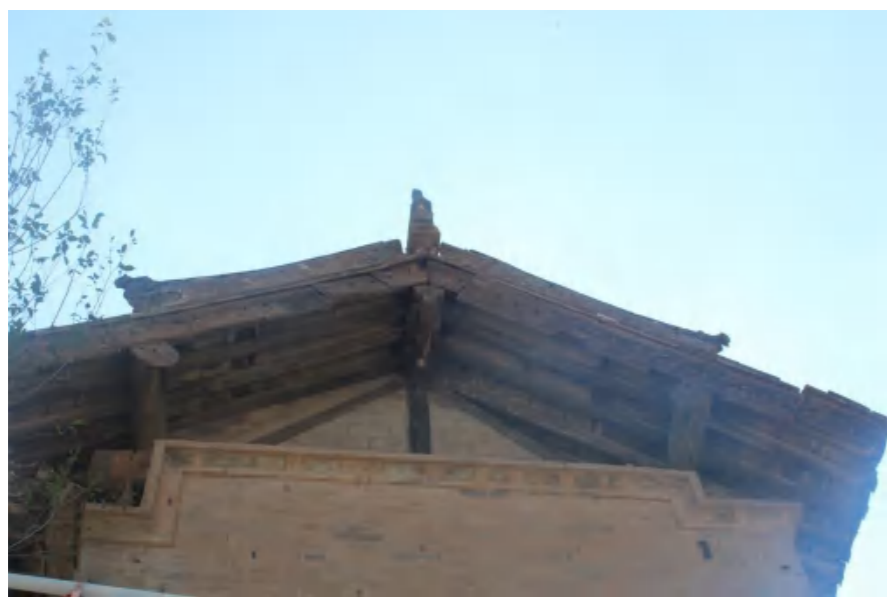
照片 4：博缝砖 30%残缺，且悬鱼缺失。
