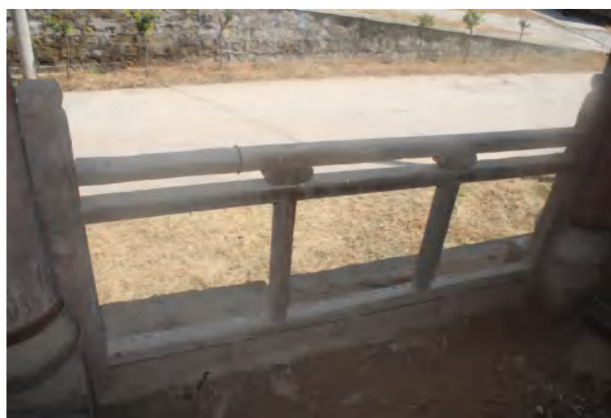
照片 35：前檐仅存东次间栏杆，且棂条缺失。
