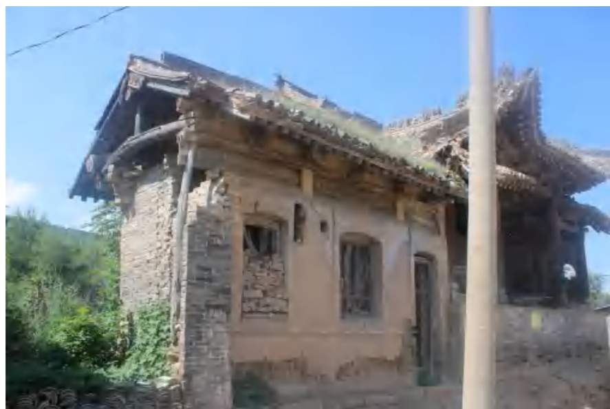
照片 10：前檐墙为后人增砌，东山墙 90%塌毁，且现存墙砖 40%酥碱。
