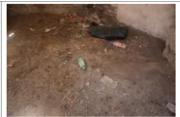
室内地面残损现状
