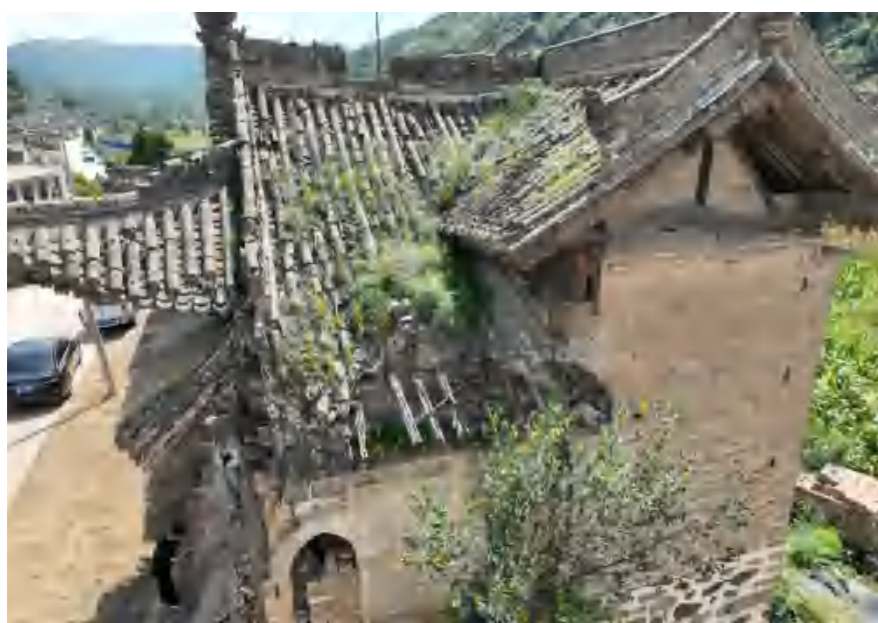
照片 4：抱厦西侧檐口屋面坍塌。
