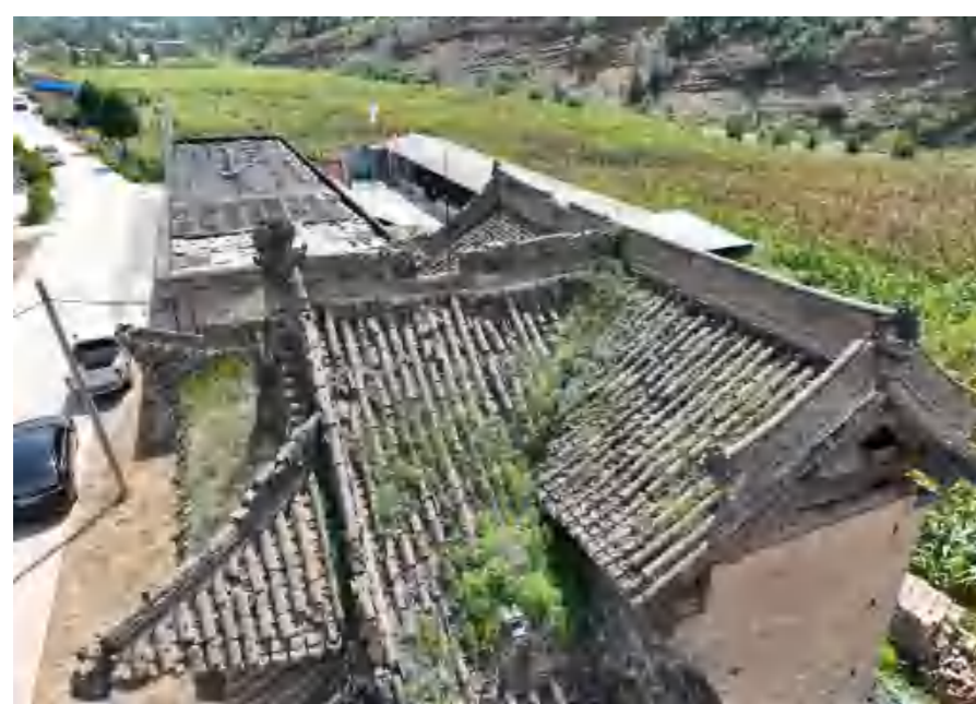
照片 1：正吻遗失，正脊合计 8 块残缺；前后坡垂脊上半部分均残缺，垂脊合计 5 块残缺，且松动、歪闪。
