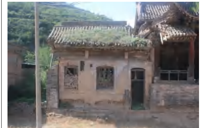
东山门屋顶残损现状
