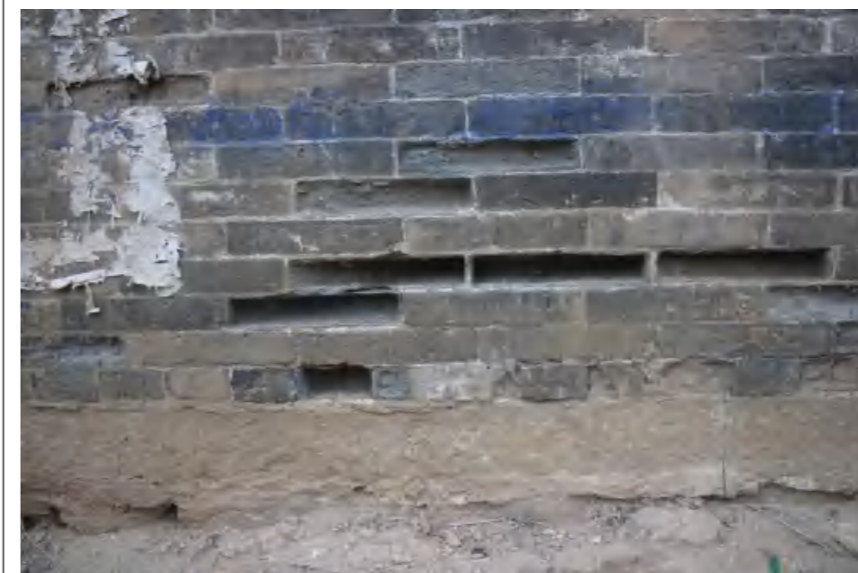
照片 33：台基砖酥碱，且灰缝脱落。
