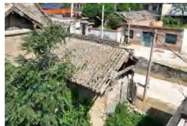
东山门屋顶残损现状
