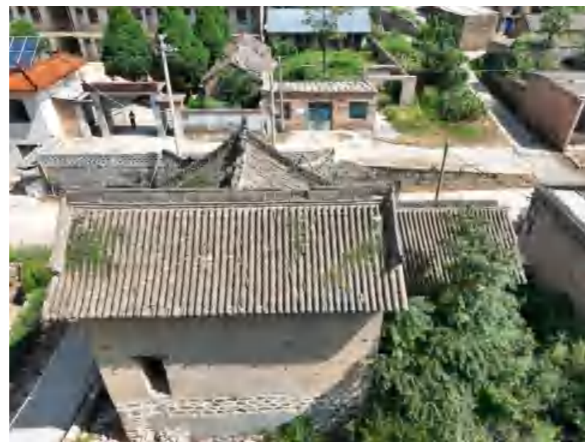
照片 2：主体屋顶瓦件合计约 80%脱节、55%起翘开裂。
