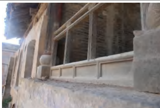
舞楼装修槛框油饰起甲、剥落
