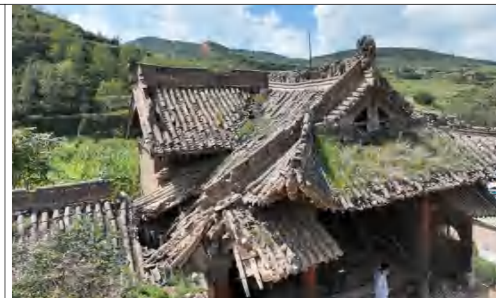
照片 3：抱厦屋顶常年雨水侵蚀下渗，逐渐导致瓦垄变形、灰泥背开裂渗雨。
