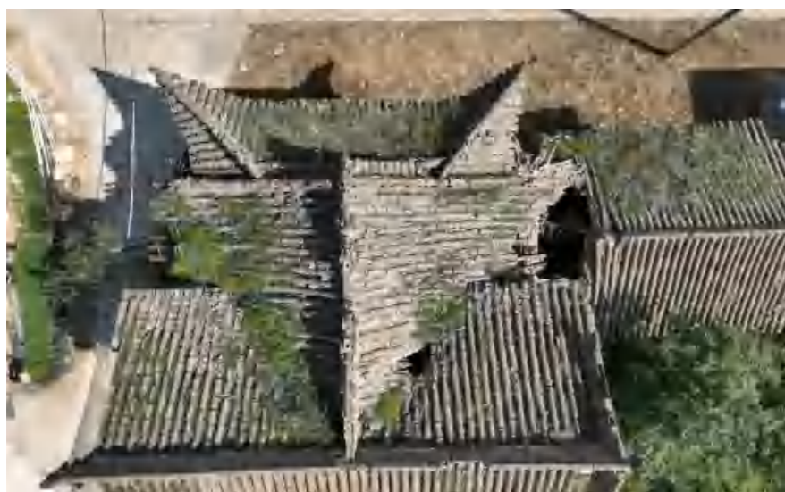
照片 1：屋面滋生杂草，瓦件合计约 95%脱节、70%起翘开裂。
