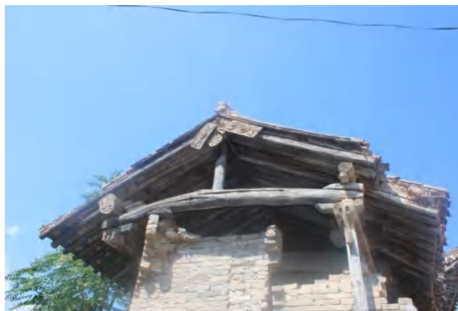
照片 8：东山三架梁通裂 1 道裂缝（裂宽达 3cm），且梁身糟朽。
