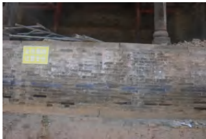
前檐台基残损现状
