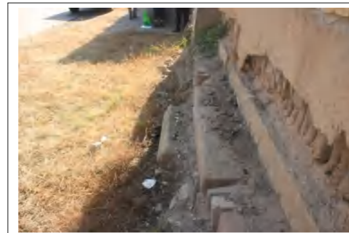
前檐压沿石残损现状
