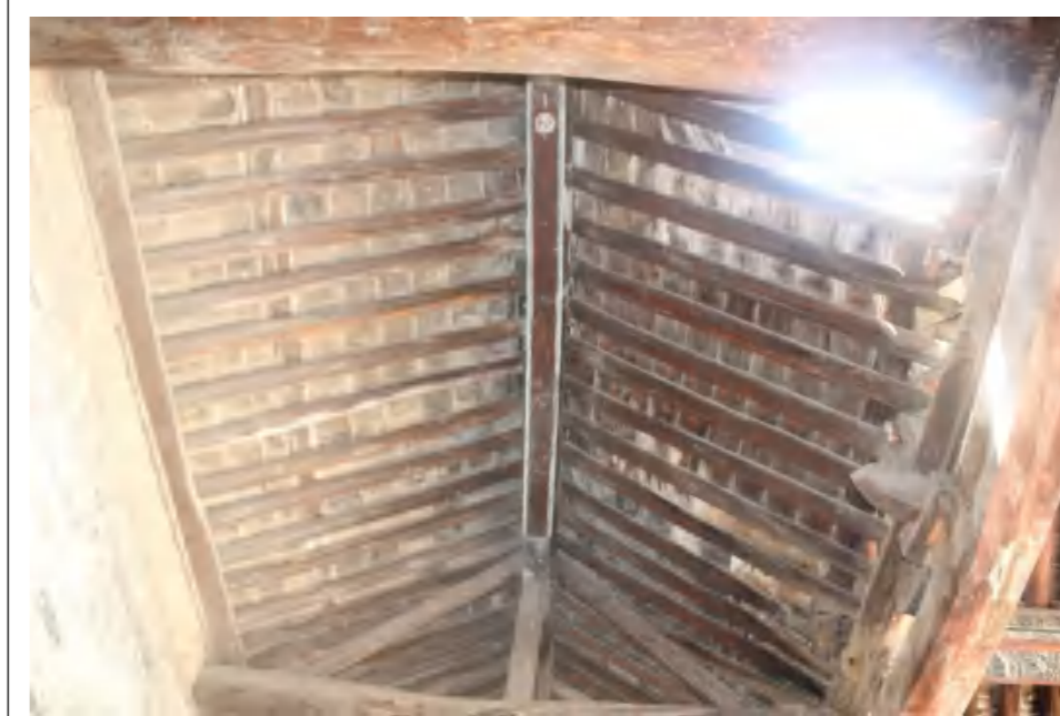
照片 3：前坡望板合计约 0.5 m²坍塌，其余均不同程度潮湿、糟朽；后坡望砖合计约 30%松动。
