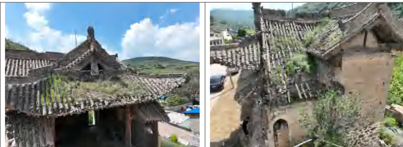
瓦件起翘、开裂现状
