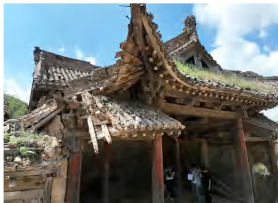
照片 5：抱厦东次间屋面局部坍塌。
