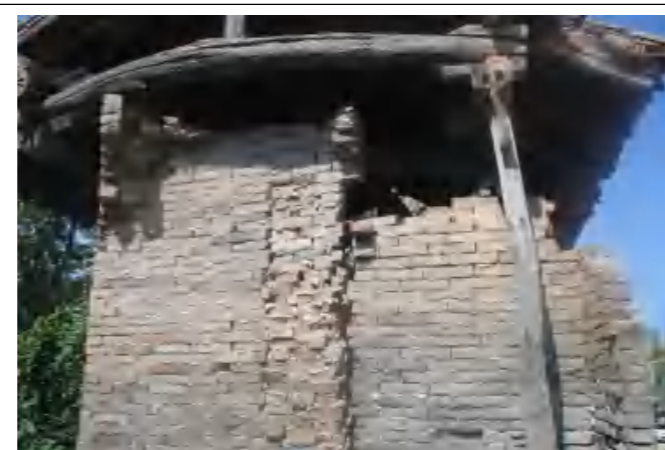
东山墙坍塌现状
