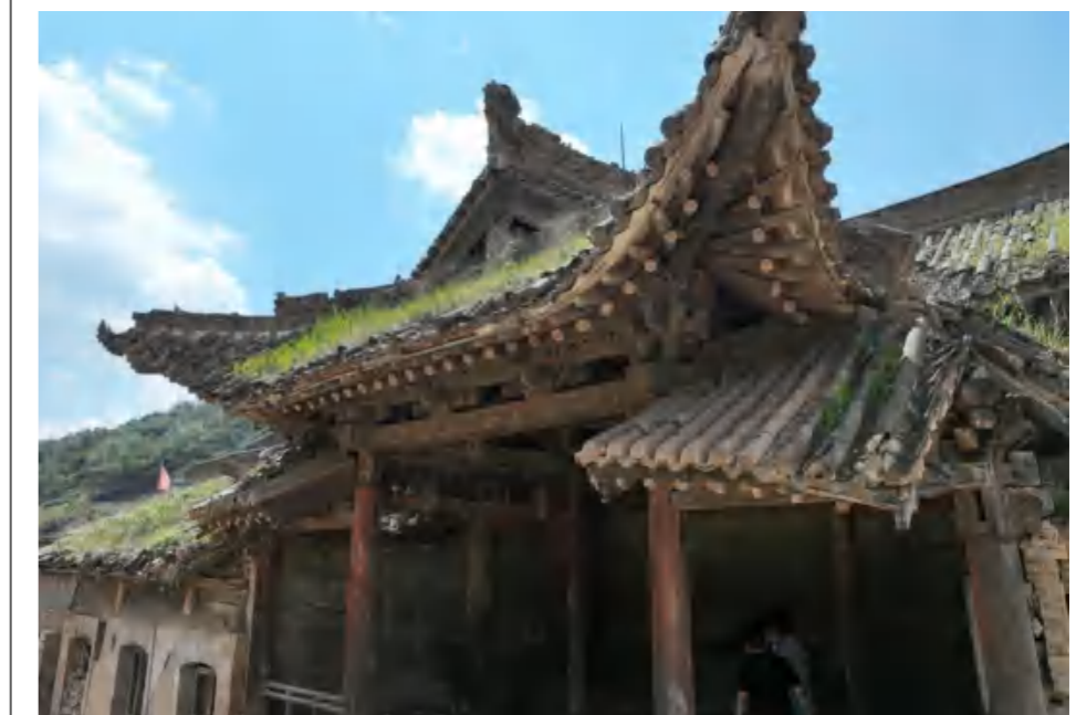
照片 6：抱厦西次间屋面局部坍塌。
