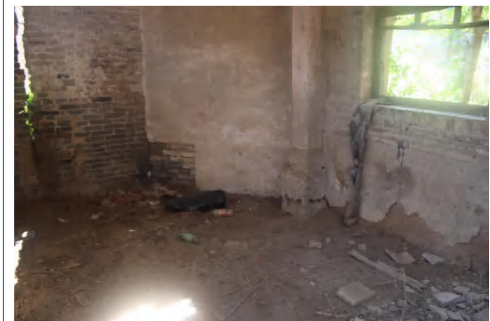
照片 12：后人增设墙体和装修现状。
