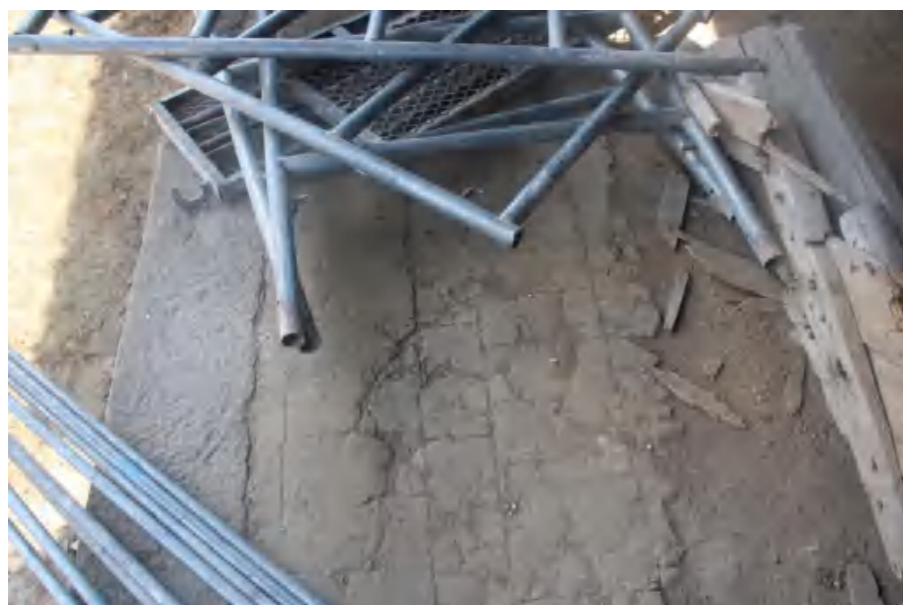
照片 34：抱厦地面条砖局部碎裂、残缺。
