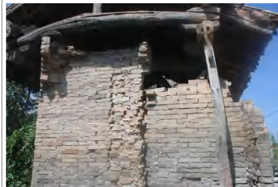
照片 9：前檐东山墙内柱糟朽、歪闪严重。
