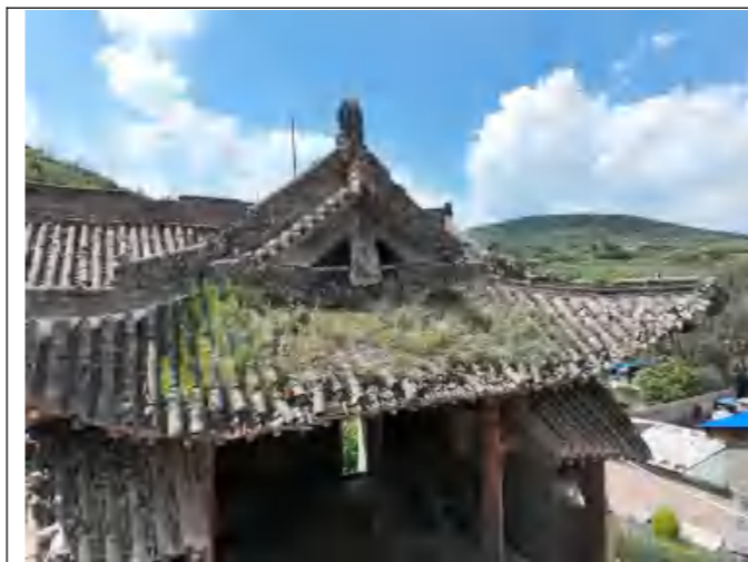
抱厦屋顶残损现状
