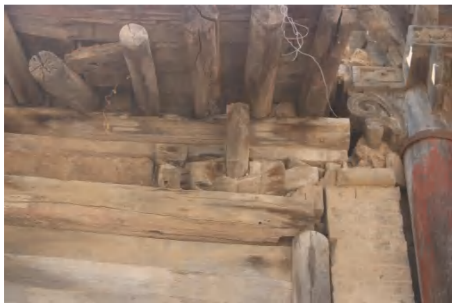
照片 7：前檐西次间平身科斗拱正心拱糟朽，槽升子劈裂，且 1 件缺失。
