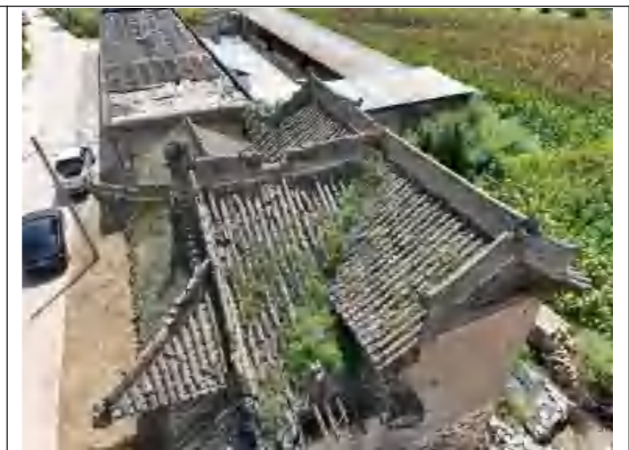
抱厦和主体屋顶残损现状
