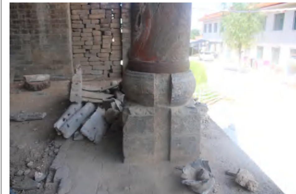
照片 36：明间与西次间栏杆缺失。
