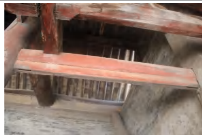
后檐缺失装修卯口现状
