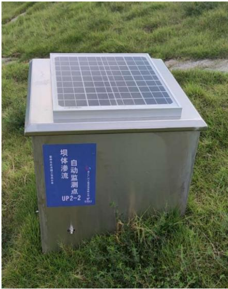
太阳能供电设备
