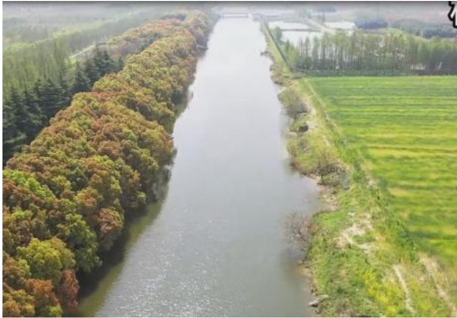
海思路北侧岸坡坍塌现状
