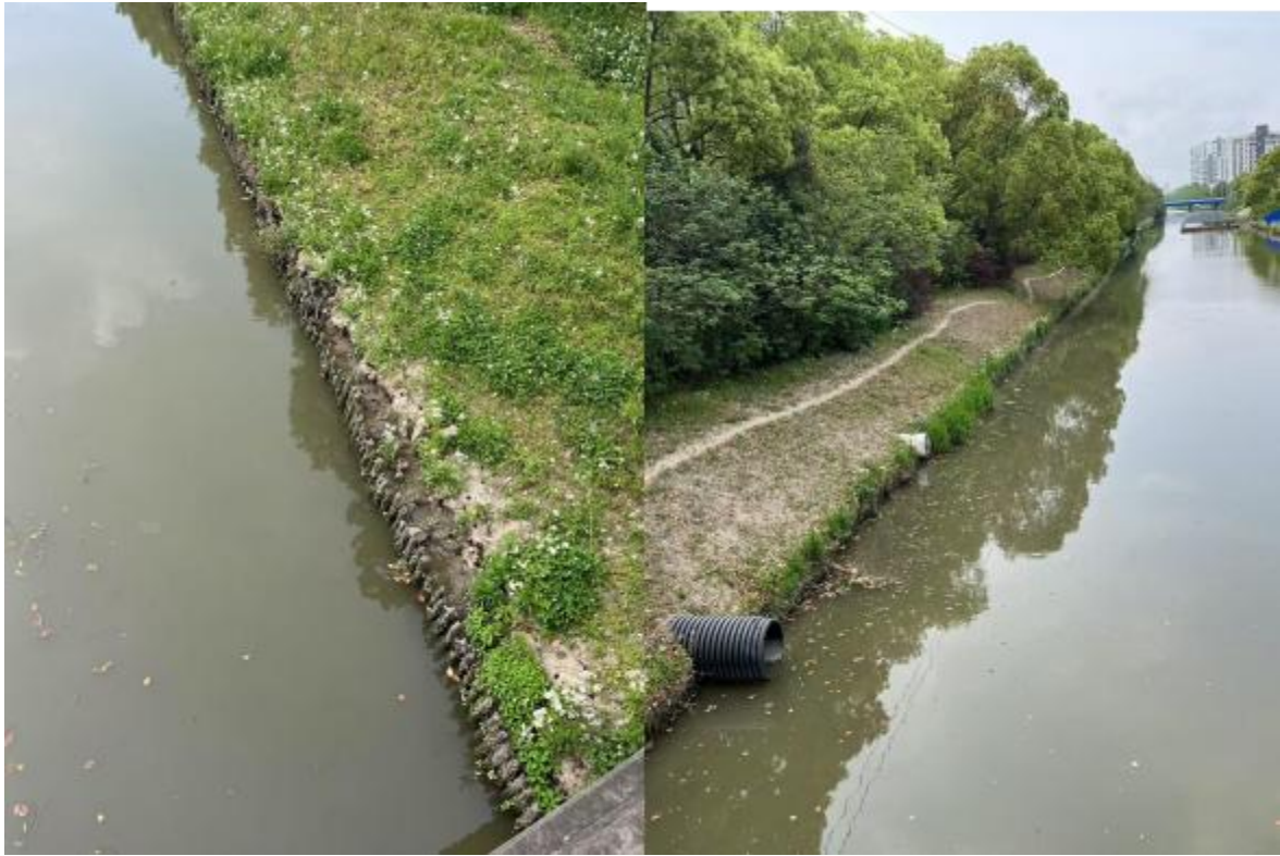
现场护岸损坏段
